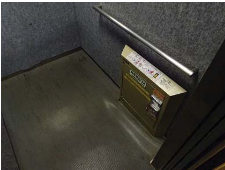
エレベーター内災害用備蓄ボックス
