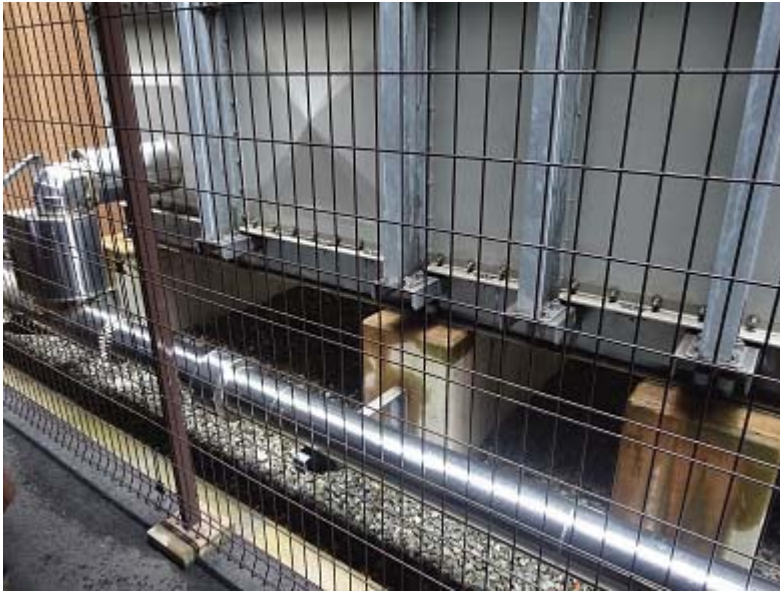
受水タンク 駐車場側
