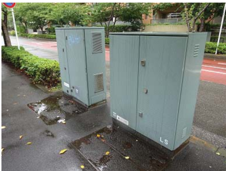
東京電力より電気の引き込み
