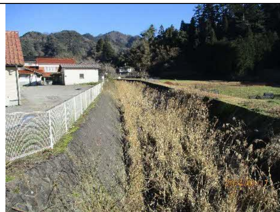
危険箇所 河床が上がり増水時の氾濫の危険があり
