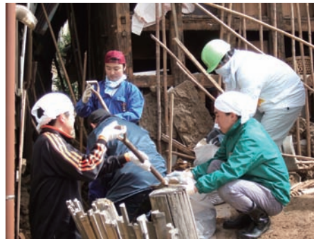
崩れた土蔵の片付けをしている様子（石川県輪島市） 写真提供：黒澤司
