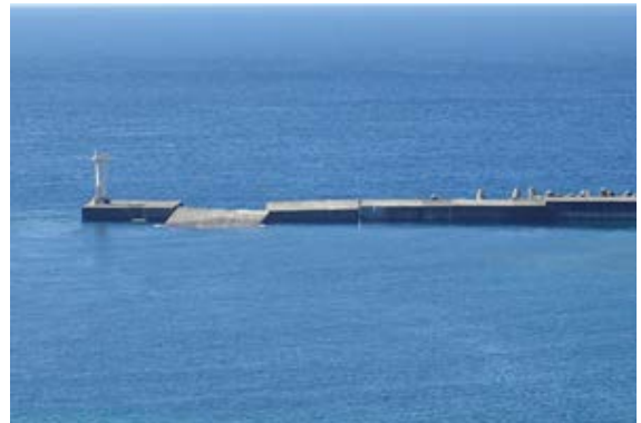
渡嘉敷港防波堤破損箇所【沖縄県島尻郡渡嘉敷村】
