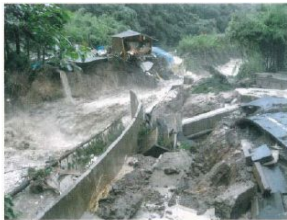
平成 18 年 7 月豪雨の大口市の被災状況
