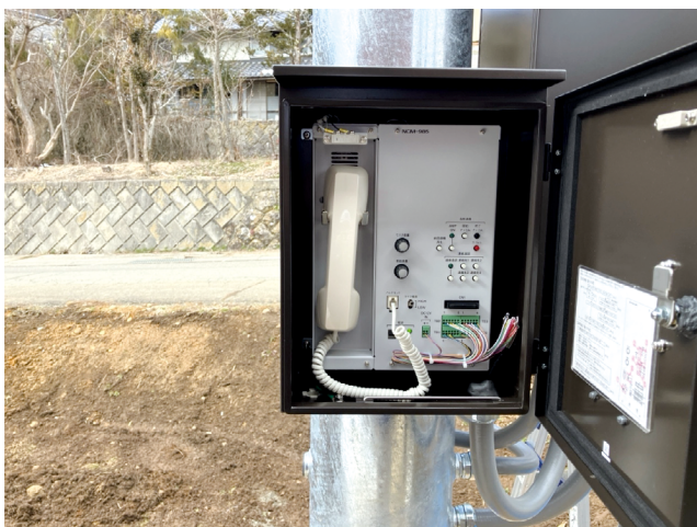
写真1 防災行政無線外部接続箱（令和6年（2024年）撮影） 停電時でも非常用電源により最大72時間ほどの無線通話が可能
