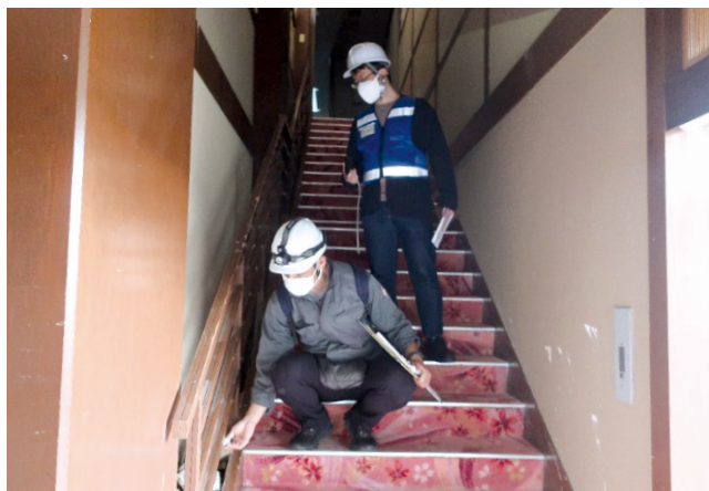
写真1 非住家建物（ホテル）の調査を行う不動産鑑定士（左）（令和6年4月27日七尾市にて、鑑定士協会連合会撮影）
