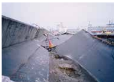
▲震災で沈下・崩壊した堤防（国土交通省近畿地方整備局淀川河川事務所提供）
