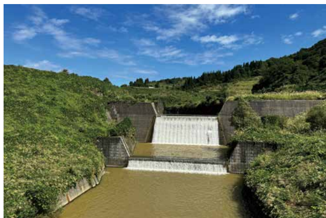
強化された東竹沢の砂防施設。砂防堰堤の奥の平坦地は地すべり堆積地(2024年9月撮影)
