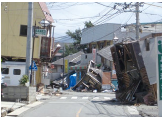
地震による損壊建物 出典：熊本県災害廃棄物処理実行計画～第1版～（熊本県）
