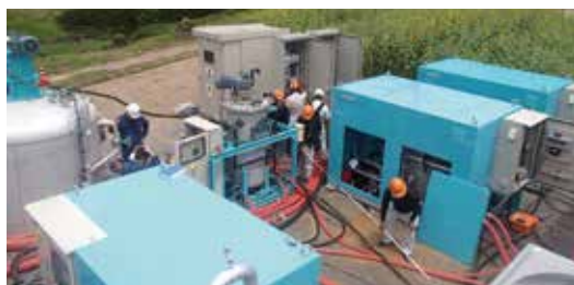
平成30年7月豪雨で被災した愛媛県宇和島市三間地区での浄水装置設置の様子
