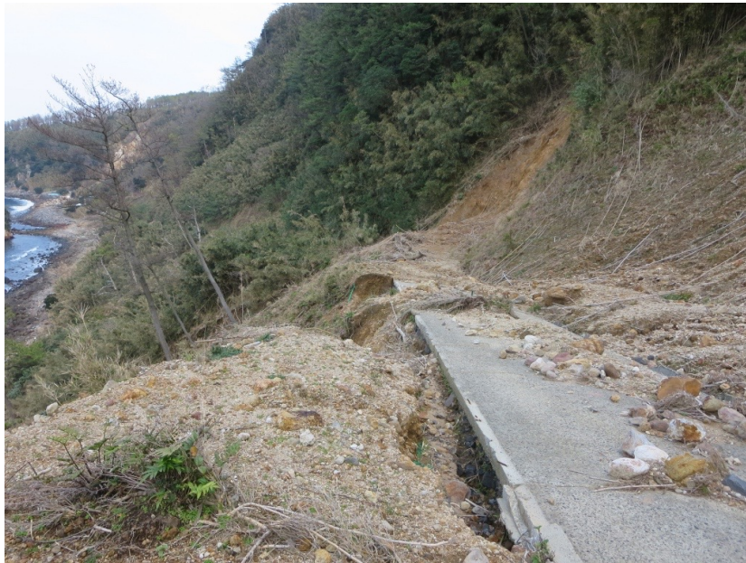
土砂災害により寸断された道路
