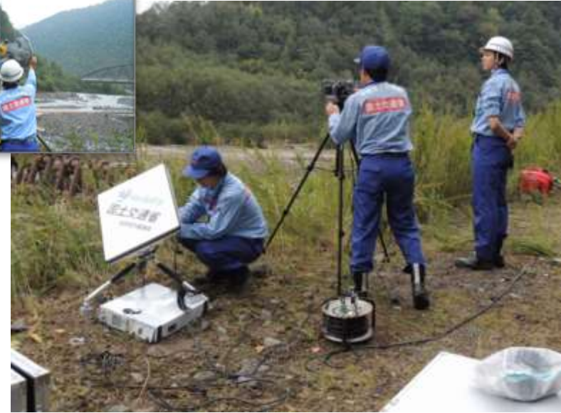
監視カメラの設置
