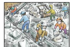
下水管や側溝の詰まりに留意
