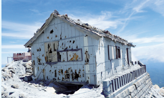
▲ Ontakesan: Edificio dañado por rocas y escombros (10 de junio de 2015) <Fotografía proporcionada por el Equipo conjunto de observación de Ontakesan>
