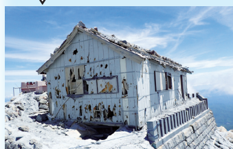
▲御嶽山：噴石で被災した建物（平成27年6月10日） （御嶽山合同観測班撮影）
