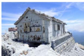
御嶽山：噴石で被災した建物（平成27年6月10日）
