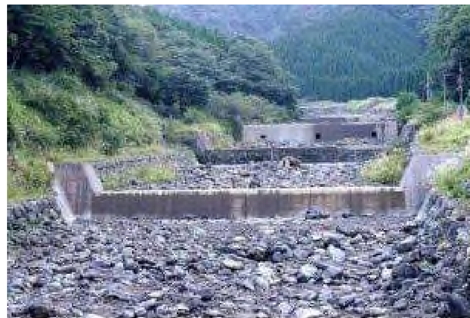
床固工群（霧島山）
