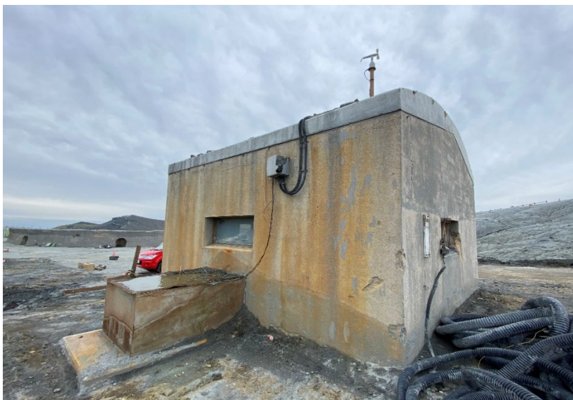
▲噴石による外壁等被害状況
