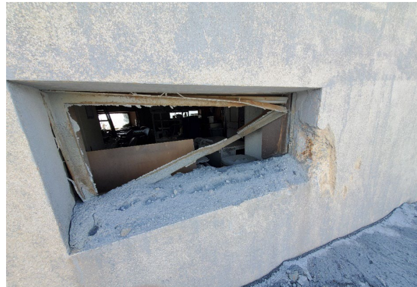
▲爆風による強化ガラス破損状況
