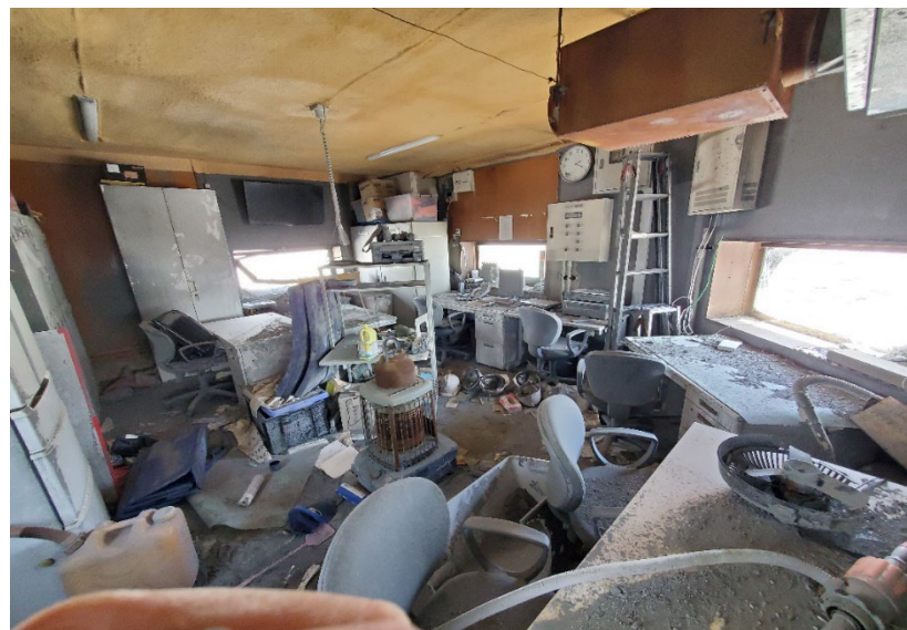
▲監視所内部被害状況
