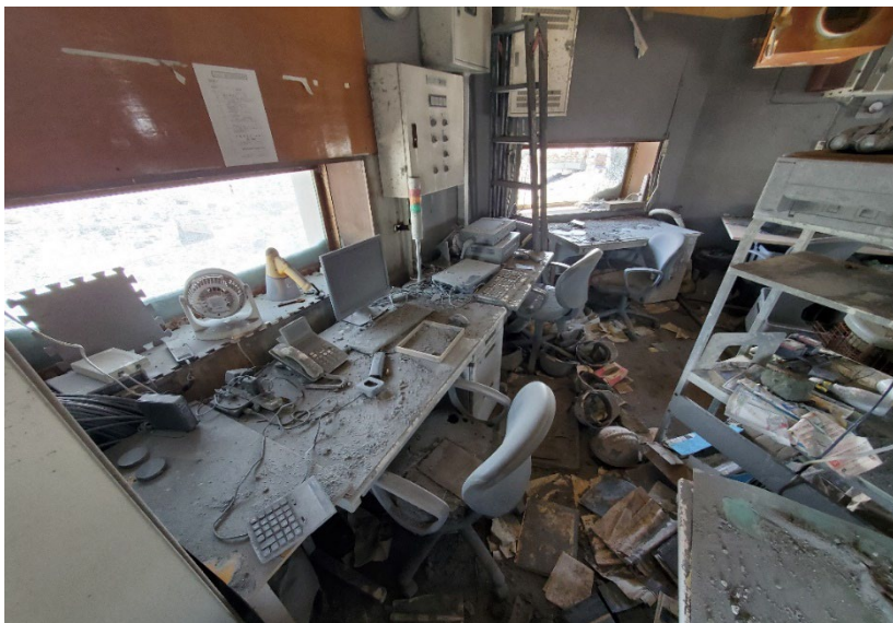
▲監視所内部被害状況
