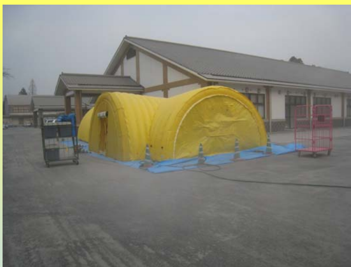
2月7日 仮設風呂の設置(駐車場) (新潟県の企業提供)
