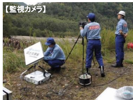
土砂移動の監視機器の整備
