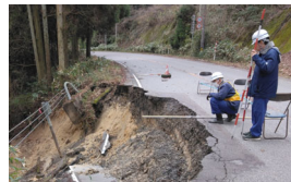
危険箇所での被災状況調査
