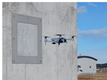
ドローンによる損傷把握
