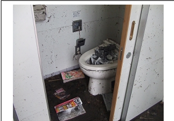
津波の泥に埋まったトイレ（釜石市）*1
