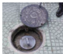
下水直結式仮設トイレ用マンホール
