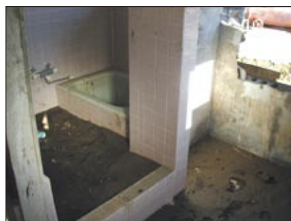
泥流により使用できなくなった浴室
