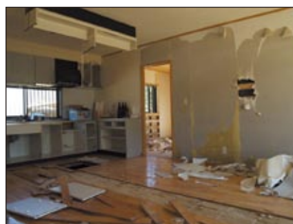
床材や壁材が吸水により剥離
