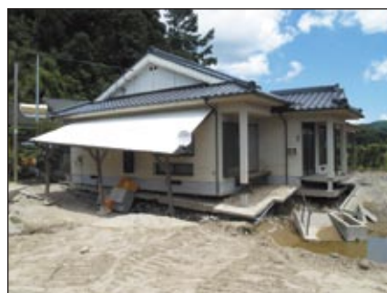
地盤流失による基礎の損傷
