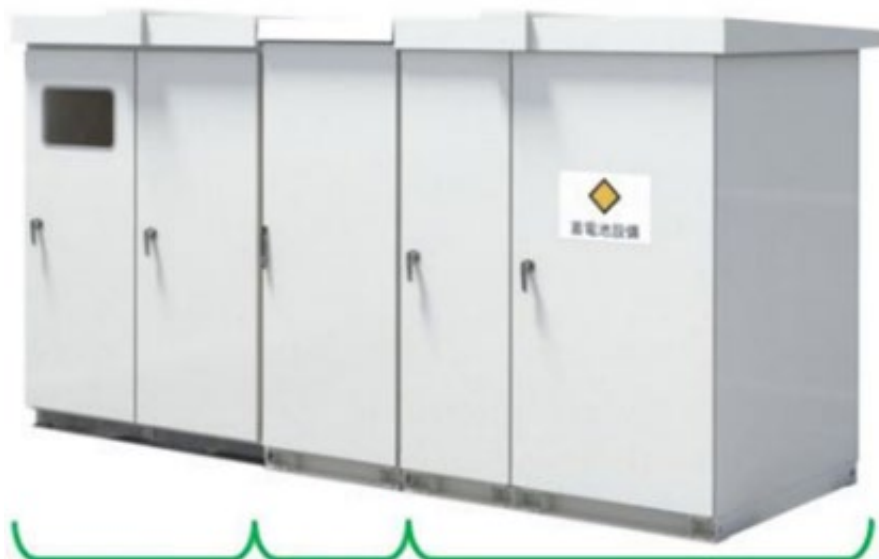
自動切換盤 インバータ盤 リチウムイオン蓄電池盤
