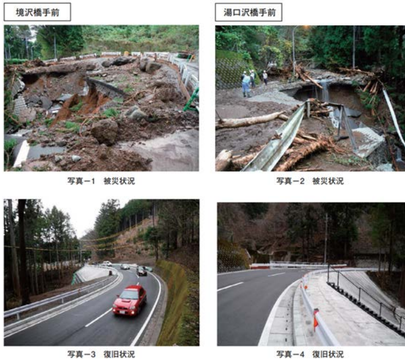
図 被災状況と復旧状況
