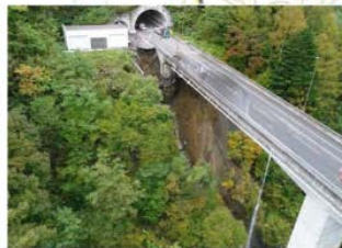
▲土砂崩落状況(遠景)
