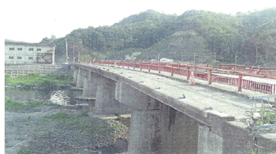
大槌橋（橋梁上部工損傷）
