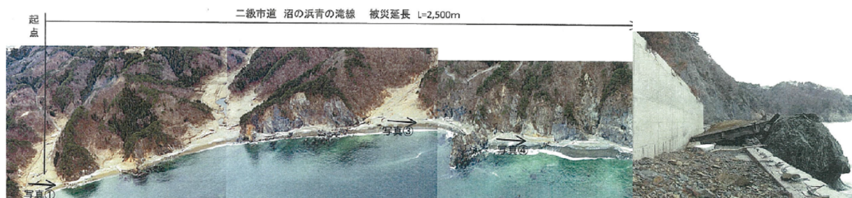
二級市道沼の浜青の滝線（道路決壊・流失）
