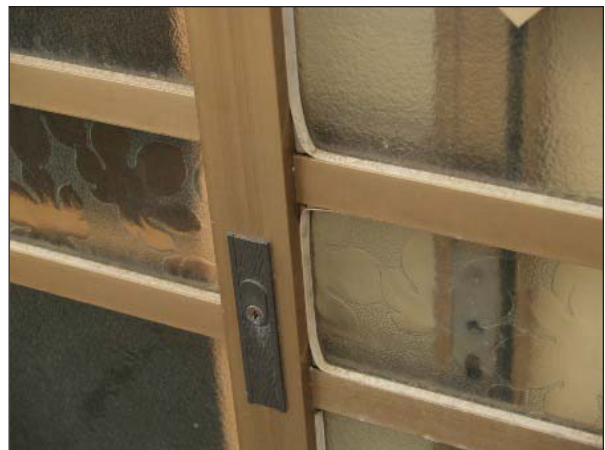
4904 【アルミサッシ】 鍵の破損や、ビード(ガラスを固定するゴムパッキン)のはずれが見られる。
