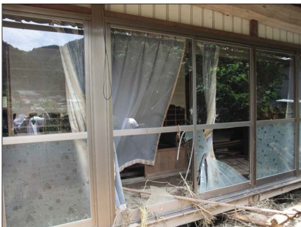
4905 【アルミサッシ】 ガラスが破損している。
