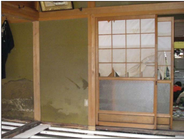
4901 【障子・襖】 浸水による襖・障子・ドアの破損(表面、格子・縁の洗浄、張り替えによって、再使用が可能な程度)
