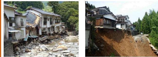
<平成29年台風18号等での基礎・地盤被害による住家被害の例>
