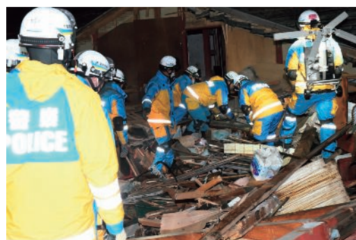
倒壊家屋現場における夜間の活動（珠洲市） 出典：警察庁
