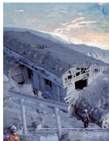
【9月28日】損壊が激しい御嶽頂上山荘 出典：長野県（2020）「長野県御嶽山噴火災害対応記録集」
