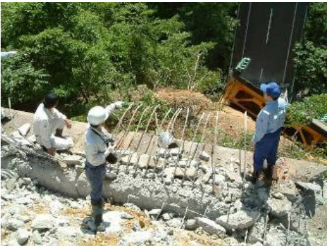
被災状況調査班(道路)
