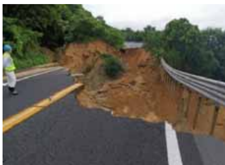
道路の災害状況 (広島県安芸郡坂町 広島呉道路)
