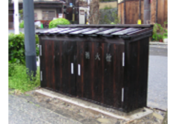
耐震性が確保された消火栓
