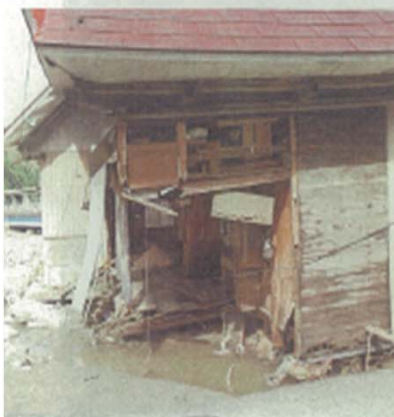
▲一階の一部が流失した家屋(叶津地区)
