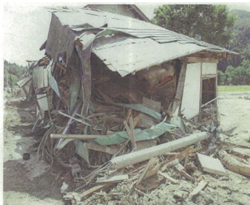
▲約50m流され、原形をとどめない家屋(八木沢地区)
