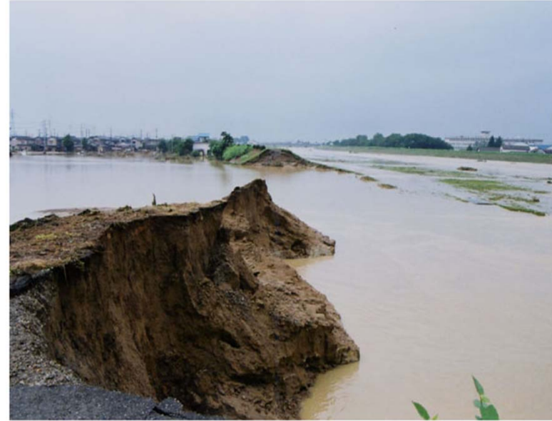
決壊した五十嵐川左岸堤防(諏訪地内)
