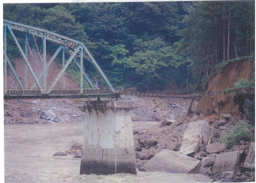
JR只見川第五鉄橋一部流失 (7月30日)
