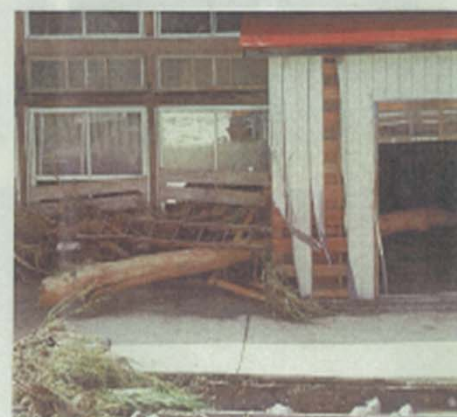
▲流木が玄関の壁に突き刺さった家屋(叶津地区)
