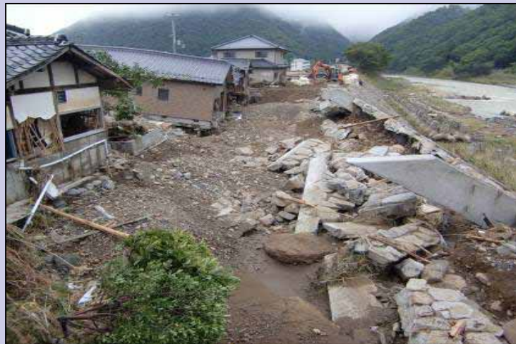
佐用川の護岸が被災(久崎地区)
