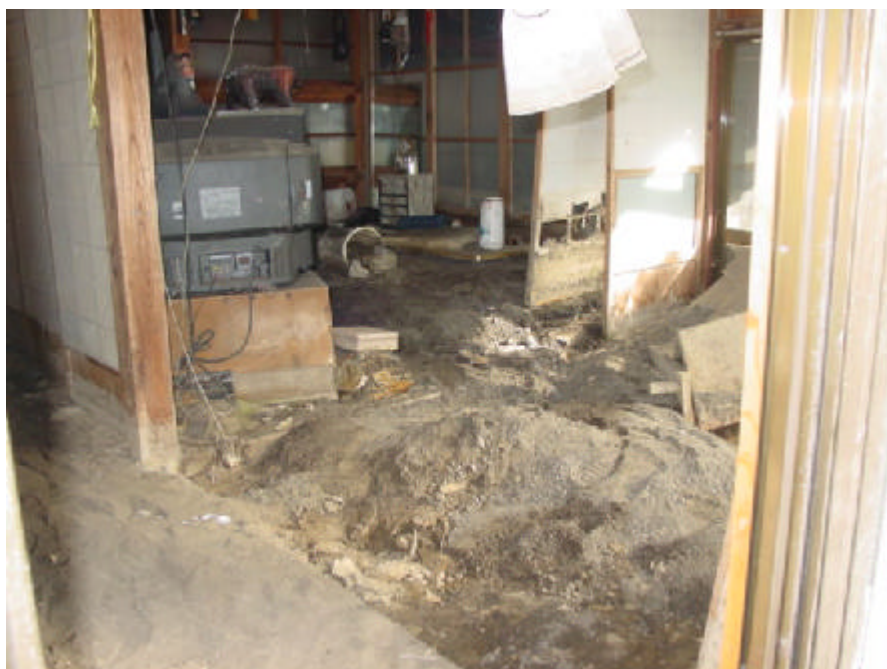
泥流により著しい被害を受けた家屋 (平成13年9月19日)
