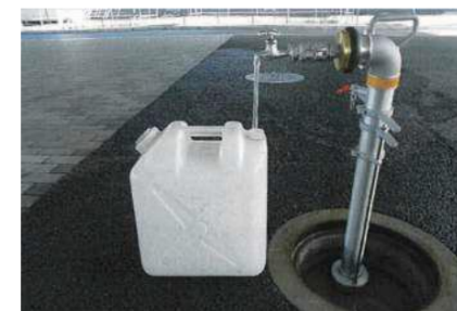
← 避難所応急給水栓
