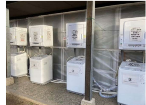
避難所に設置された洗濯機
