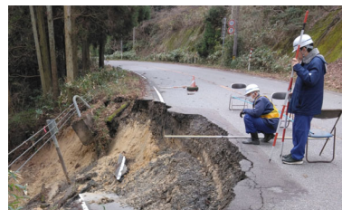
危険箇所での被災状況調査
