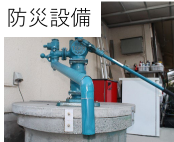
▲防災用井戸のポンプ整備
