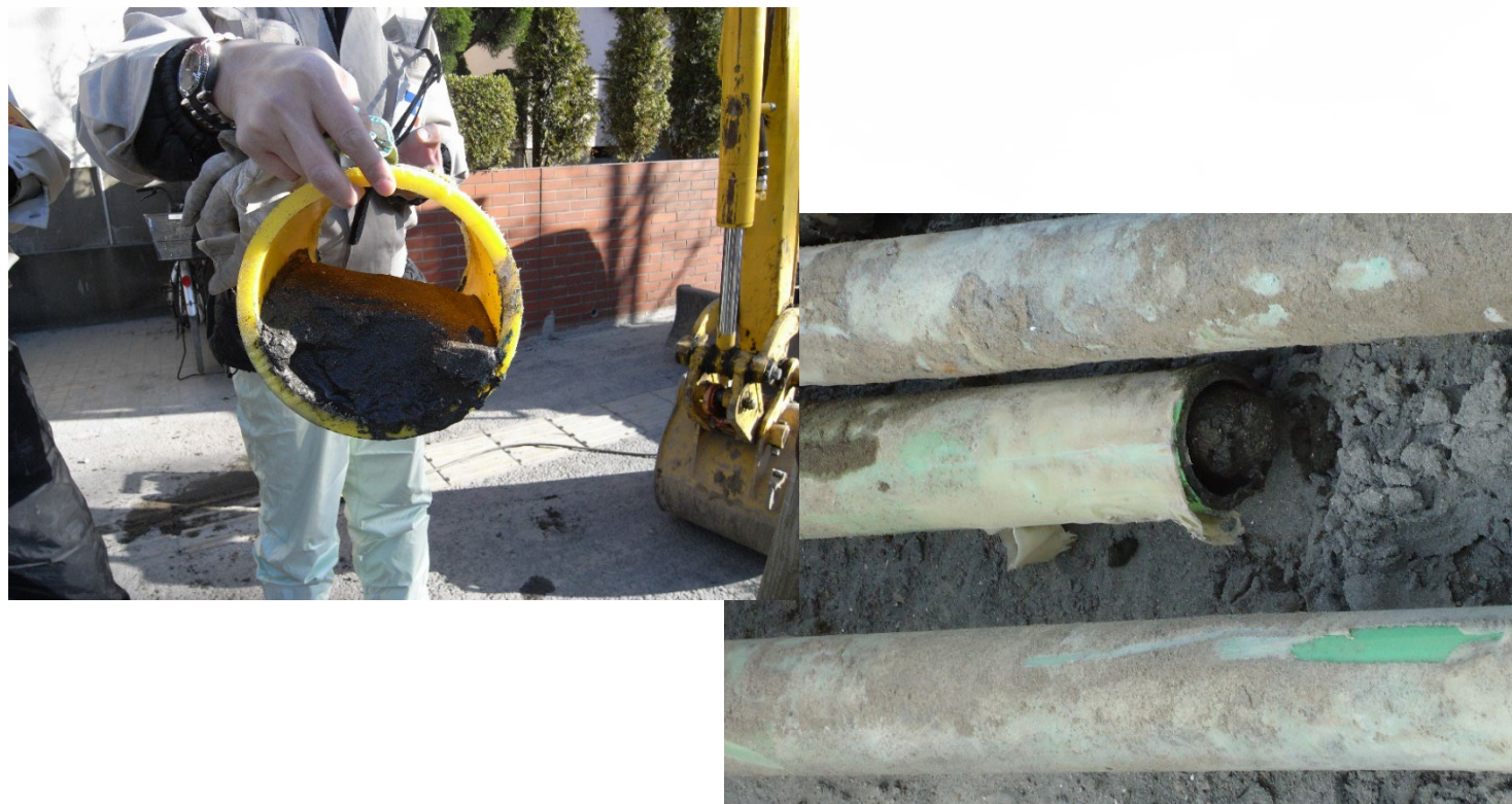
土砂が流入したガス管（液状化エリア）
