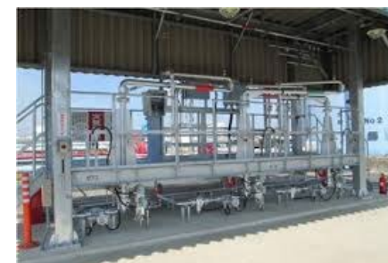
ドラム缶充填出荷設備
