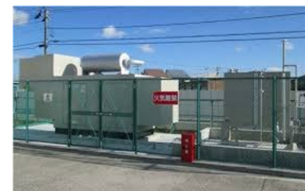
非常用発電機
