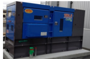
<非常用電源設備>
