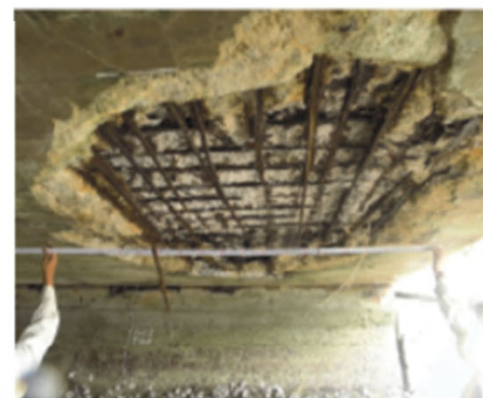
内部の鉄筋が露出した橋梁
