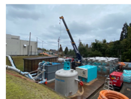
▲浄水場での活用(珠州市) 施設Ⅱ
