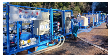
▲可搬式浄水施設（施設Ⅰ）の全景
