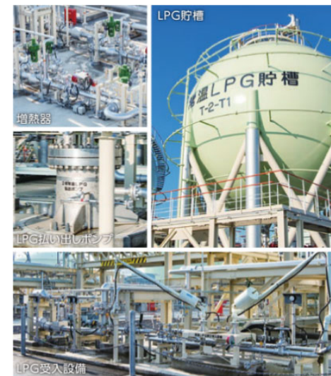
都市ガス製造所（姉崎火力）
