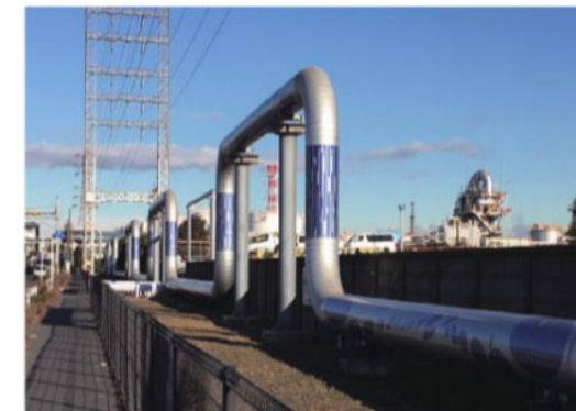
蒸気を供給する配管（川崎火力）
