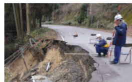
危険箇所での被災状況調査
