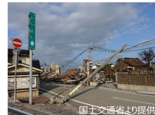
電柱の倒壊事例
