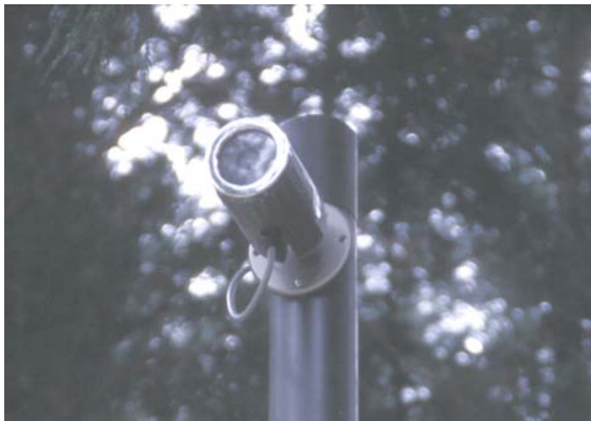
自動火災報知設備 炎感知器(高知 豊楽寺)
